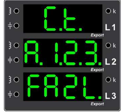
Örnek Hata 3. Tüm fazların akımlarının yüksek olduğunu gösteren ekran görüntüsü (Tüm fazların akım girişlerini ve tüm akım trafo değerini kontrol ediniz.)
