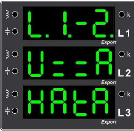
Örnek Hata 22. Otomatik gerilim-akım eşleşmesi kapalı olduğu durumlarda; 1. ve 2. fazların gerilim-akım uçlarının eşleşmemiş olduğunu gösteren ekran görüntüsü (1. ve 2. fazların gerilim ve akım uçlarının doğru sırada bağlandığından emin olunuz.)
