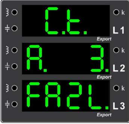
Örnek Hata 1. Üçüncü fazın akımının yüksek olduğunu gösteren ekran görüntüsü (Üçüncü faz akım girişini ve akım trafo değerini kontrol ediniz.)
